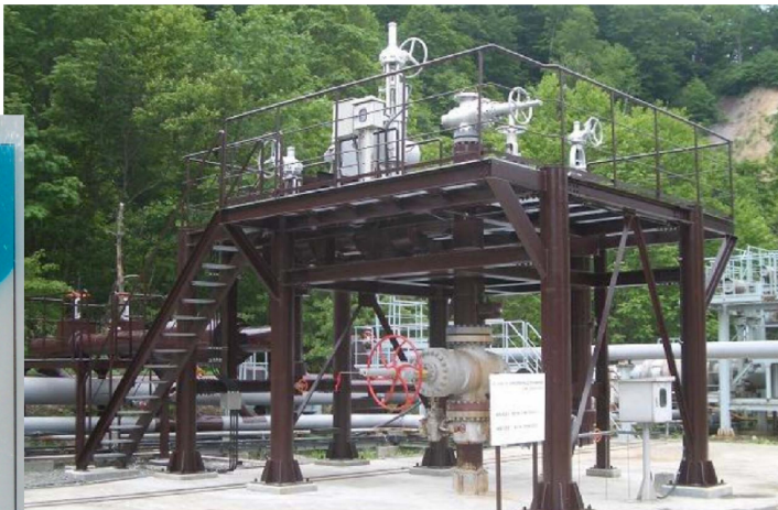
「生産井等の坑口装置」(出典:「葛根田地熱発電所蒸気部門の紹介と展望」加藤修、2011/7/7、東北大学震災フォーラム)
