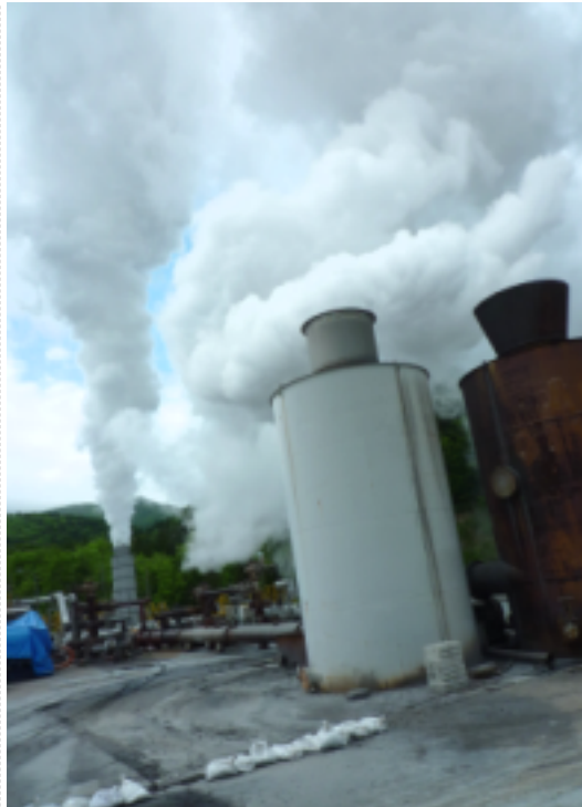
東北電力(株)上の岱地熱発電所・生産井戸の噴出実験中の様子。通常稼働はしていなかった。配管が複雑に張り廻る。(2011/6/17)
